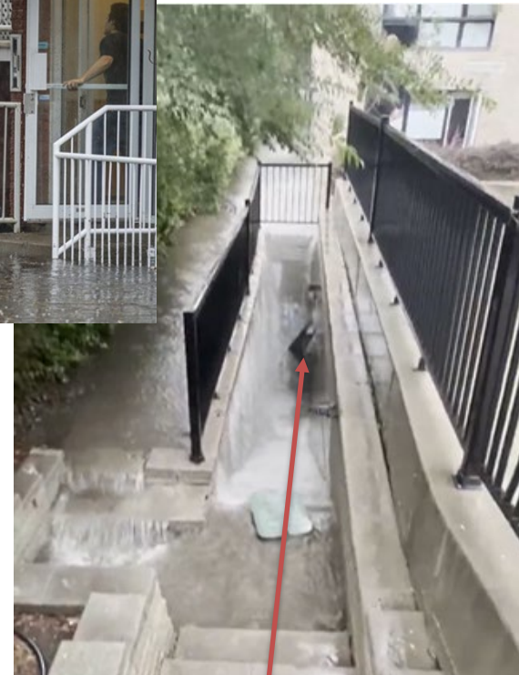
Issue de secours d'un stationnement souterrain défoncée par la pression de l'eau
